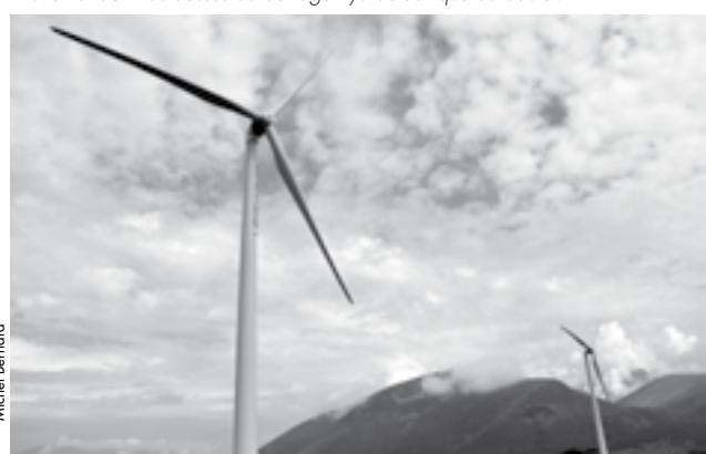
▼ Deux éoliennes installées à Pellafol par un propriétaire privé d'origine allemande... au-dessus du barrage hydroélectrique du Sautet.
