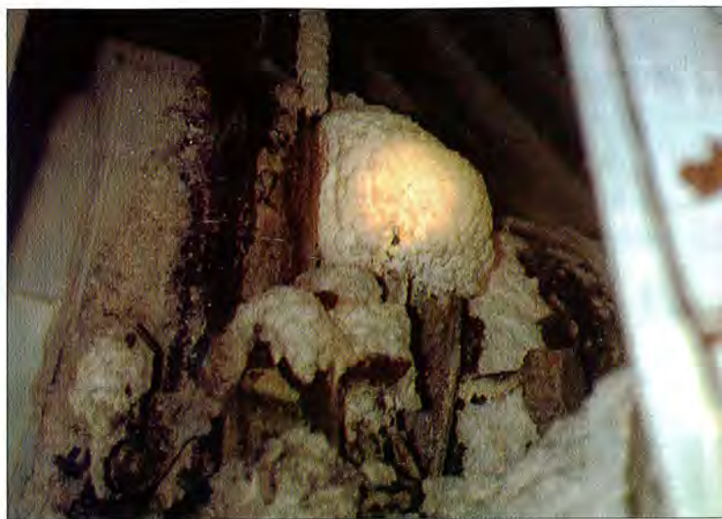
Décembre 1995, fuite de sodium à la centrale de Monju
