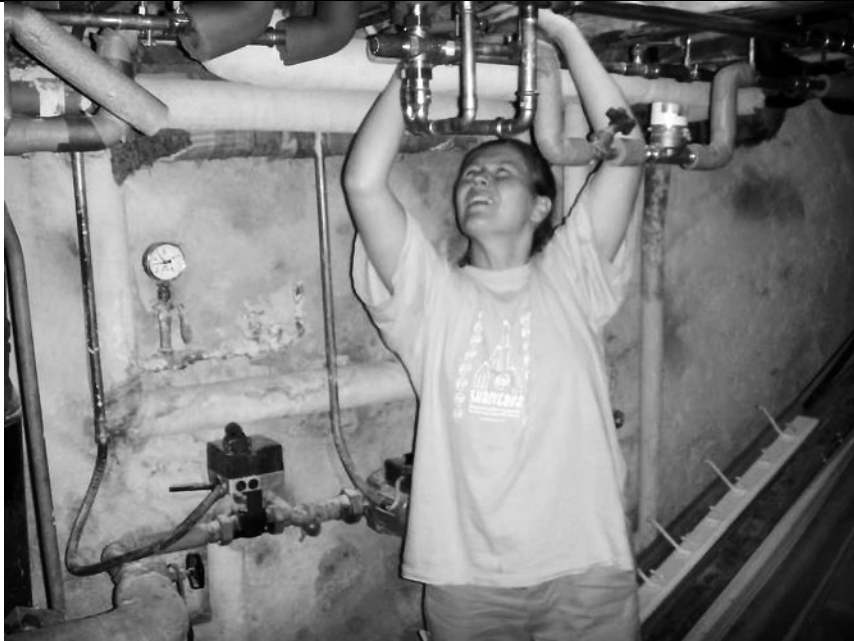
▲ Et oui, pour le solaire aussi, il faut bidouiller des tuyaux !
