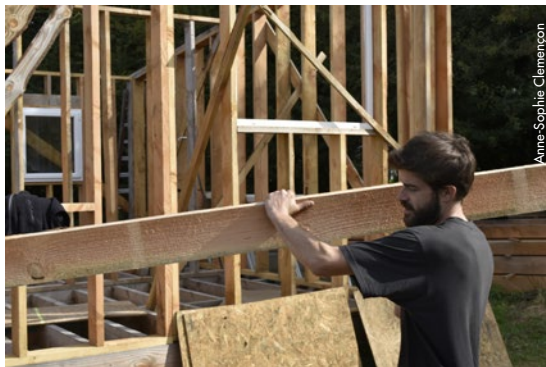
Maison en construction (ossature bois, remplissage en paille) aux Fosses noires, collectif où se trouvent une boulangerie et une brasserie.
