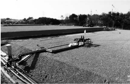
▲ Un des réservoirs enterrés qui fuit...
